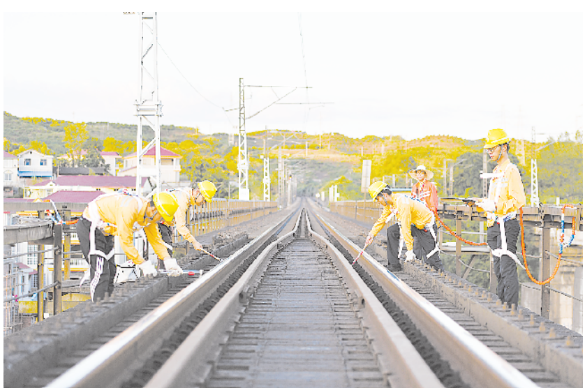
错峰巡检 保障暑运安全
