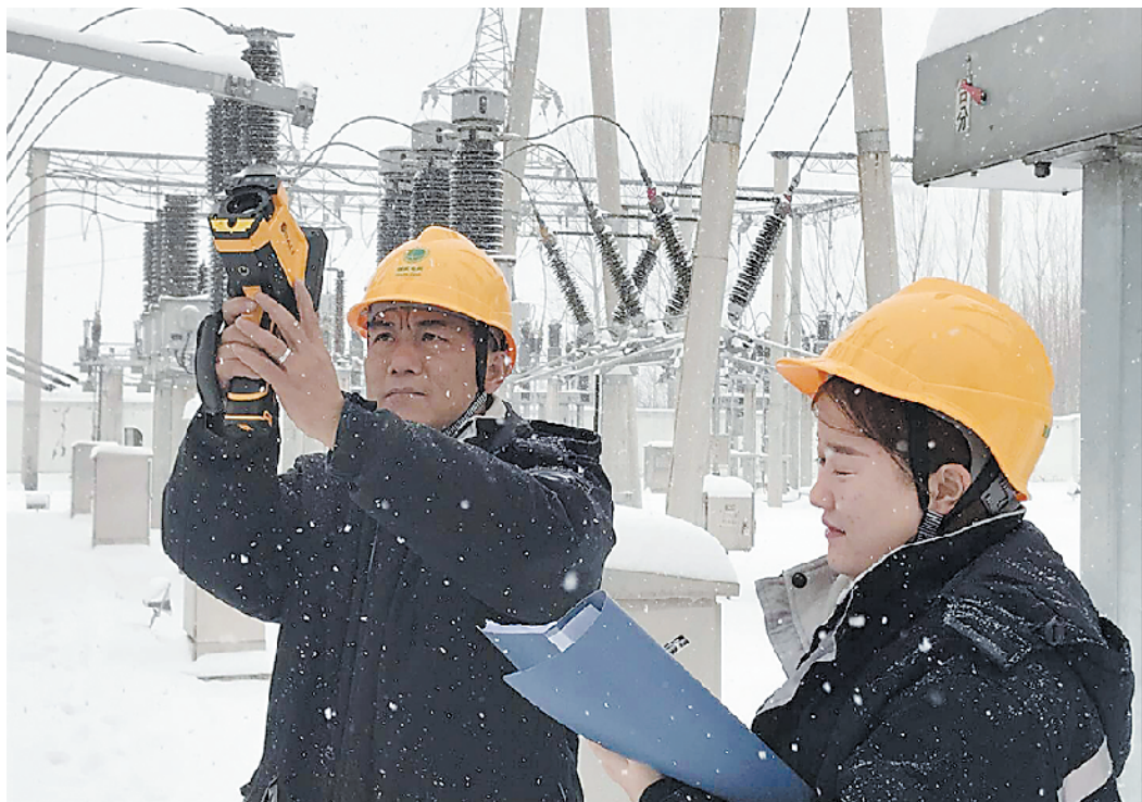
运维人员冒雪巡视35千伏变电站。
