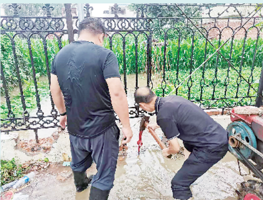
市气象局工作人员排除气象观测站院内积水。
