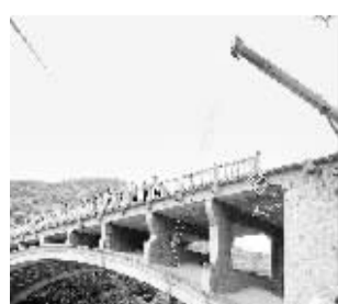
贵州黄平一汽车坠河7死1伤 7月9日,7时许,一辆双排座货车在经过位于贵州省黔东南苗族侗族自治州黄平县重安镇一座混凝土公路桥时,失控撞断桥体护栏坠入重安江中,事故导致车上7人死亡1人受伤。新华社发
