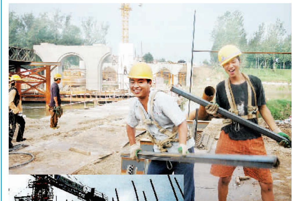
为早日完成施工任务,贾鲁河大桥工地上的建设者在确保建设质量的同时不断加快建设进度,为打造美好新周口做出了积极贡献。(记者 沈湛 李寒 陈卫东 孙安平 王映 摄)
