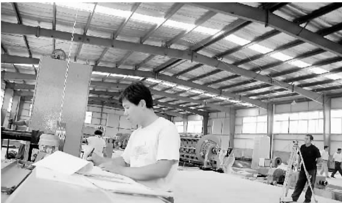
市经济技术开发区在工业园区建设中坚持科学规划,合理布局,为企业发展创造良好环境。图为园区内一家食品企业在安装生产线。(陈卫东 摄)
