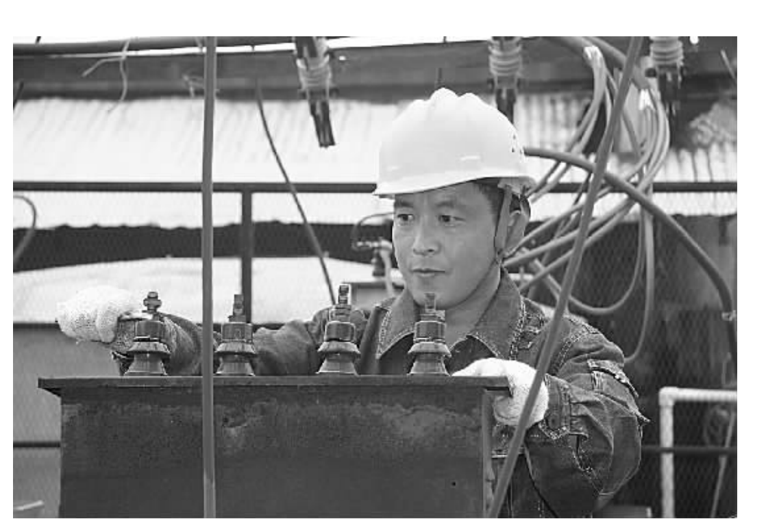
为确保群众节日期间用上安全电、放心电，鹿邑电业局近日对所属供电设备开展安全大检查。图为该局城区供电二所在为设备“体检”。（张文杰 摄）
