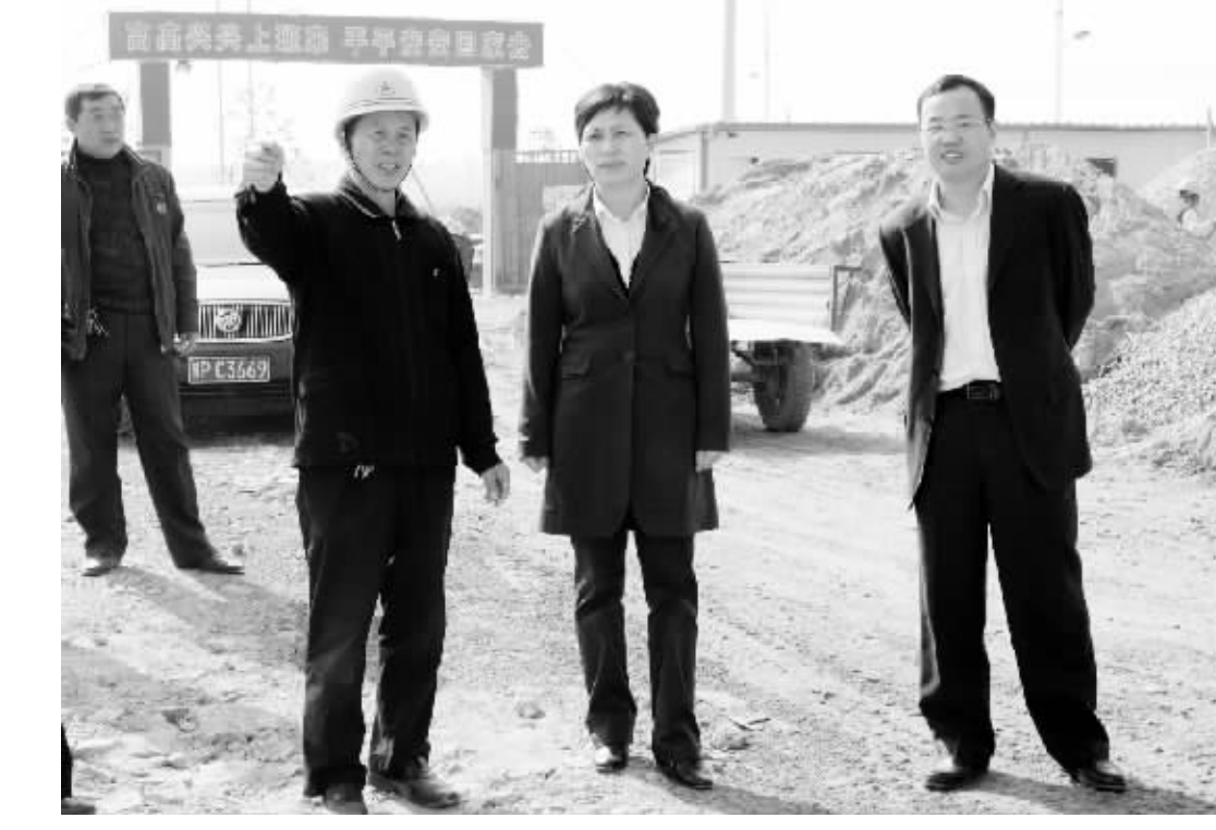
10月27日,周口市委常委、项城市委书记王宇燕在该市产业集聚区管委会主任张建党陪同下,深入项城市产业集聚区调研。在项城市纺织有限公司项目施工现场,王宇燕指出,要充分抓住当前有利的天气时机,在确保质量的前提下,加快一期12万锭纺纱厂项目施工进度,确保如期竣工,早日完成老厂搬迁任务。(卜越 摄)
