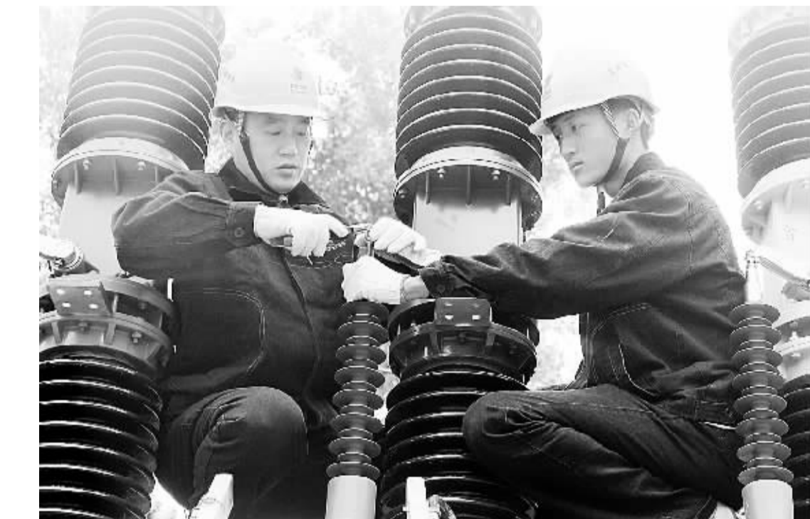
为确保迎峰度夏期间安全可靠供电,太康县电业局抓住近日负荷下降的有利时机,对马厂、王集两座35kV变电站进行增容改造,为保障居民生产生活用电奠定基础。近日,工作人员正在王集变电站组装SF6断路器。(李标 郎志强 摄)
