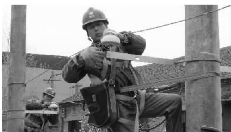
为进一步提高员工的实践操作水平, 熟练掌握岗位操作规程及标准化作业流程, 5月20日, 郸城县供电公司组织开展了技术比武活动。图为比武现场。郭庆兴 刘兴刚 摄
