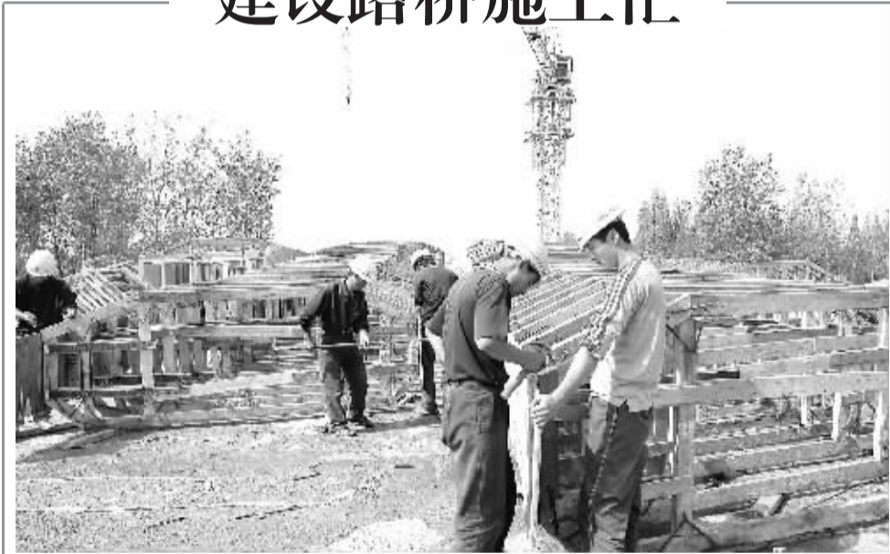
昨天, 周口市建设路桥上工人们在紧张施工。据该工程施工人员介绍, 目前, 建设路桥体北部正在进行箱梁施工, 而桥体南半部箱梁已经浇筑结束, 正在进行张拉工作。
