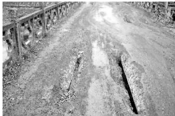
太康县清集乡黄口水闸桥面上的两道裂缝给周边村民出行带来诸多不便。据了解,周边村民要经过这座桥才能到乡里和县城,而桥面上的这两条裂缝已经存在好几年了,一直没有人修整。
