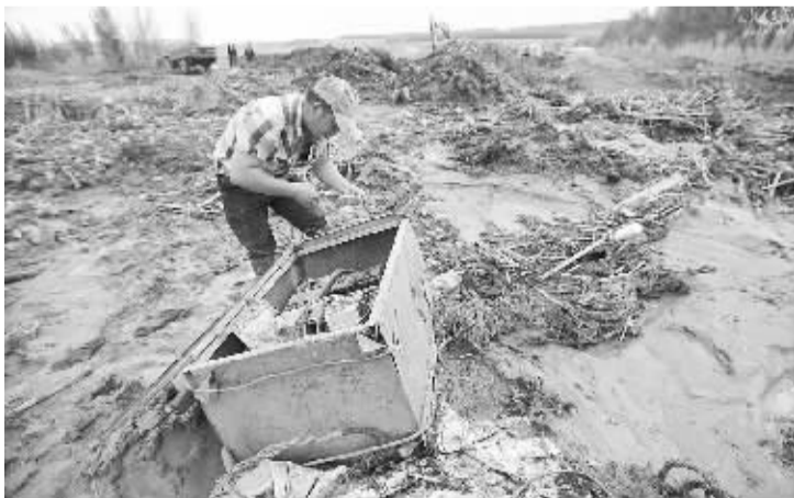
6月8日,在黑龙江省海林市长汀镇宁古村,工作人员正在修复水毁电力设施。
