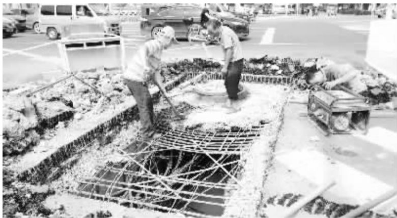
《大雨过后 新修路面下沉开裂》后续▶▶
